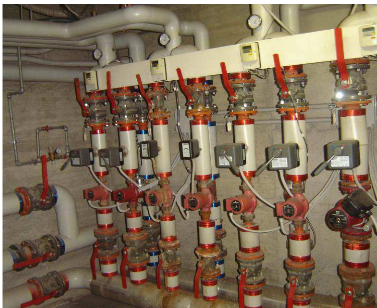
Figura 11 - Locale pompe sito al piano interrato della Scuola secondaria di primo grado
