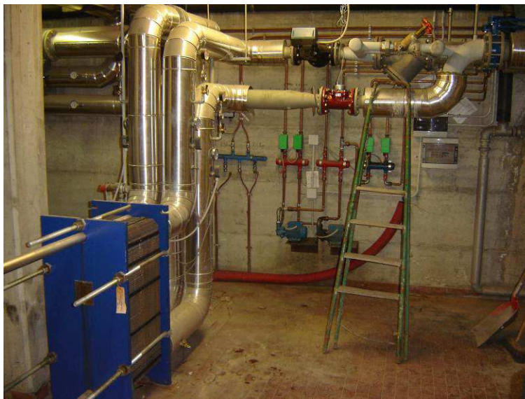
Figura 10 - Centrale termica sita al piano interrato della Scuola Elementare
