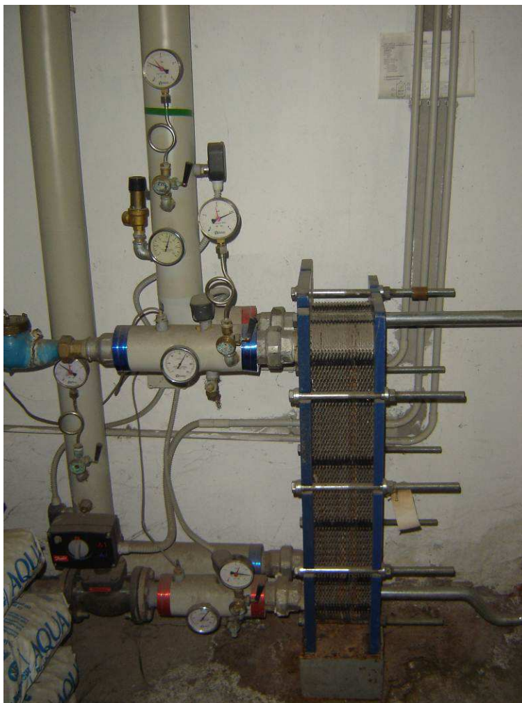
Figura 10 - Centrale termica sita al piano seminterrato dell'edificio
