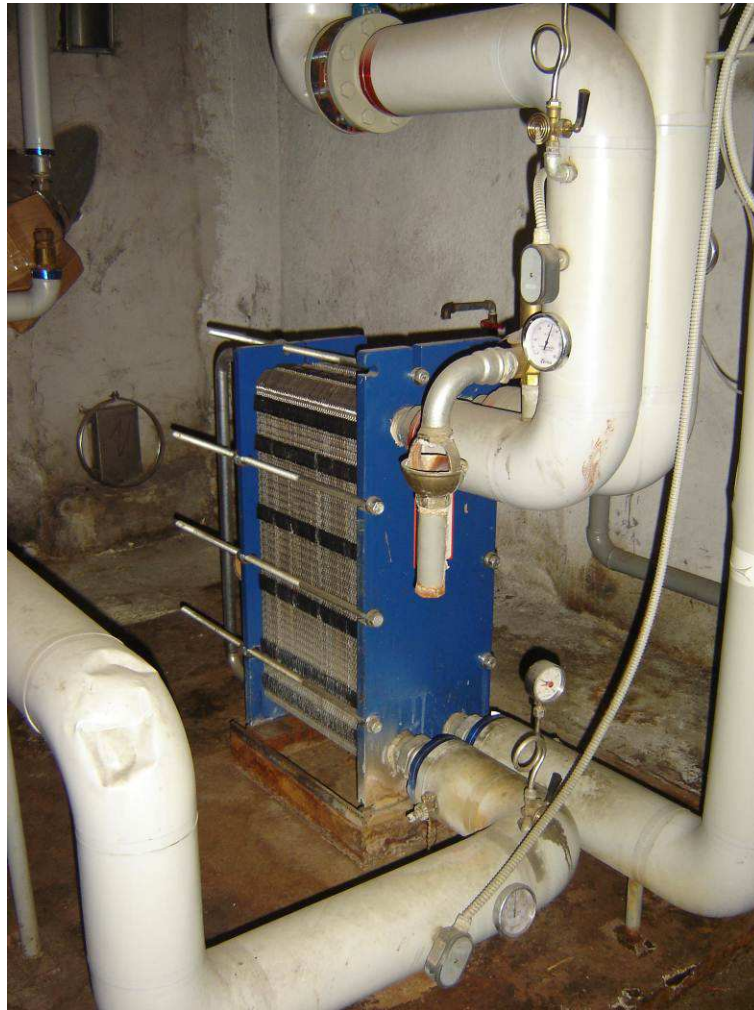
Figura 6 - Scambiatore per il riscaldamento sito nella centrale termica al piano interrato della vecchia Scuola Media
