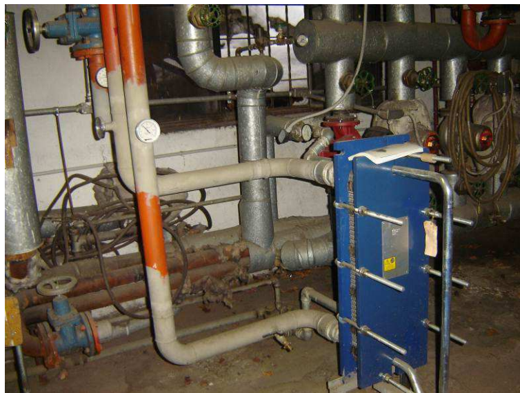
Figura 7 - Scambiatore per acs sito nella centrale termica al piano interrato della vecchia Scuola Media
