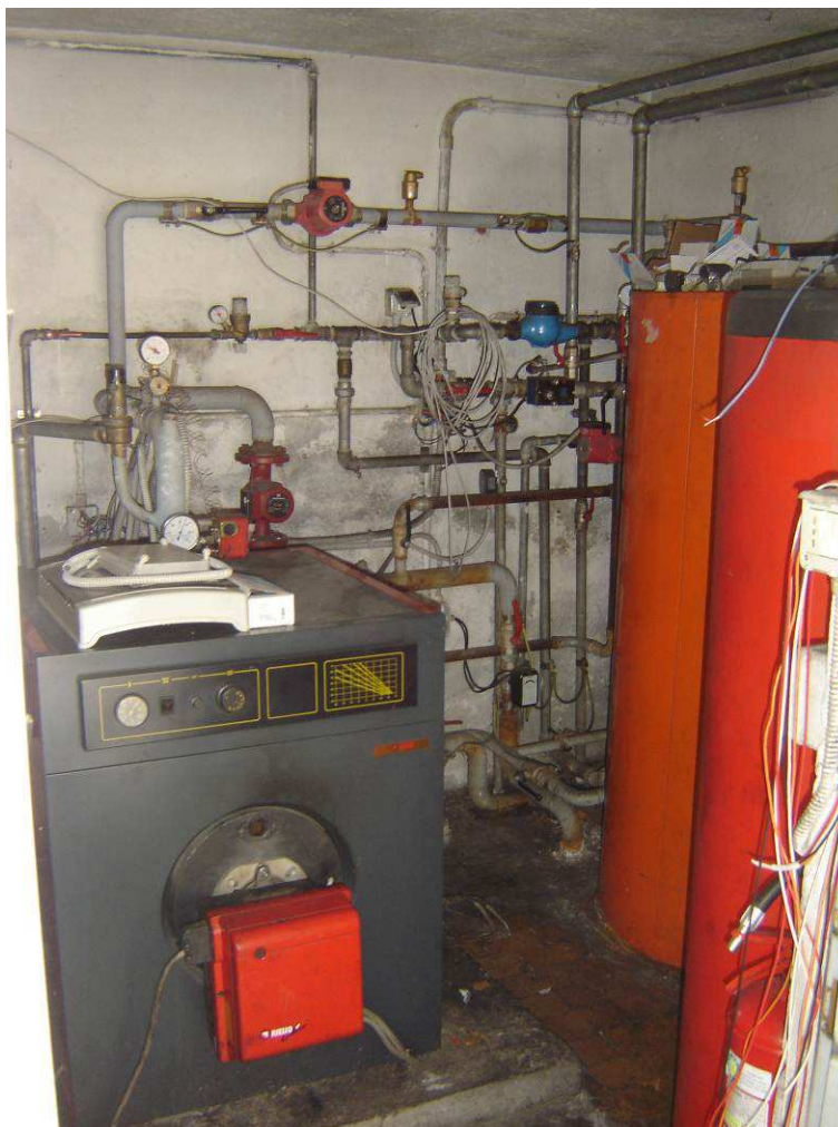
Figura 7 - Centrale termica dell'edificio
