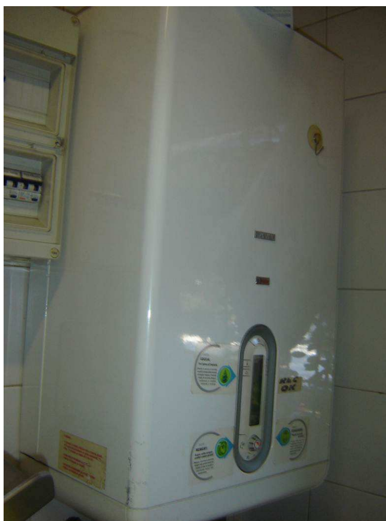
Figura 7 - Caldaia a metano
