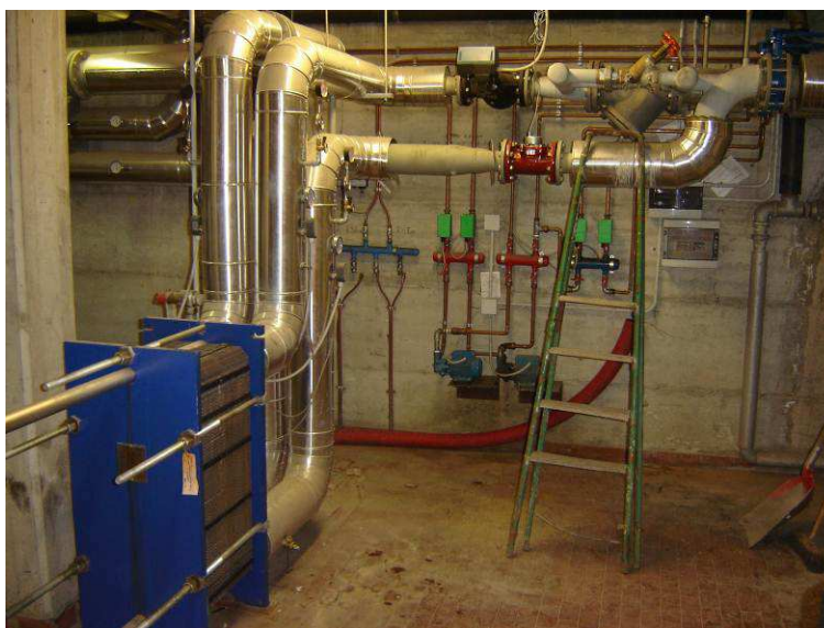
Figura 5 - Centrale termica sita al piano interrato della Scuola Elementare
