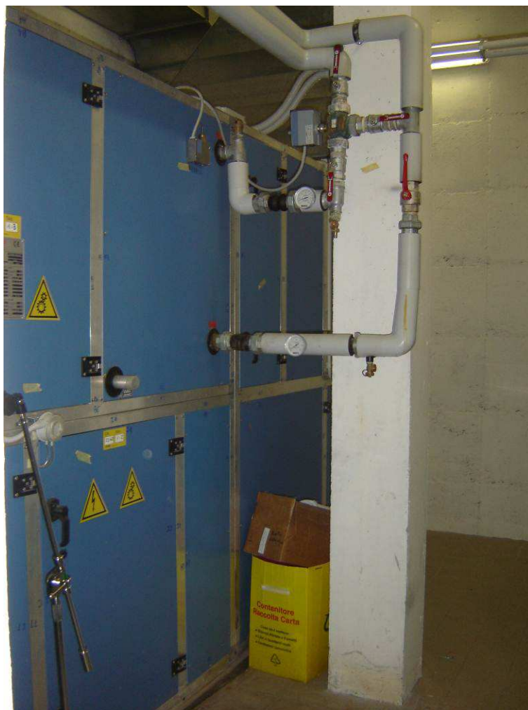
Figura 7 - Unità di trattamento aria a servizio dell'auditorium
