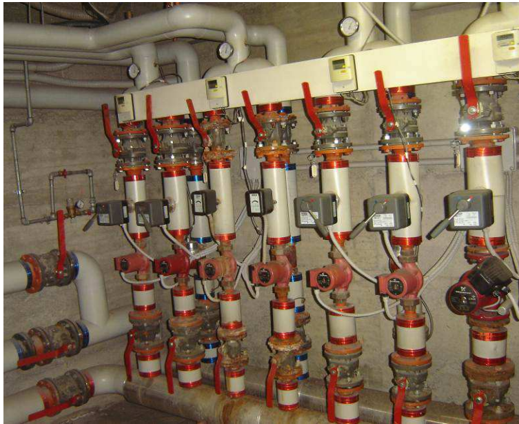
Figura 6 - Locale pompe sito al piano interrato della Scuola Media
