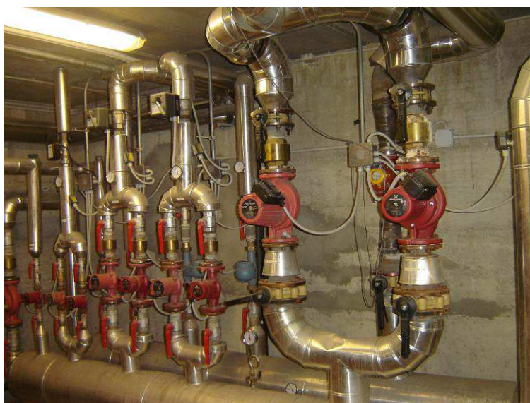
Figura 9 - Pompe a servizio della Scuola Elementare ubicate in centrale termica
