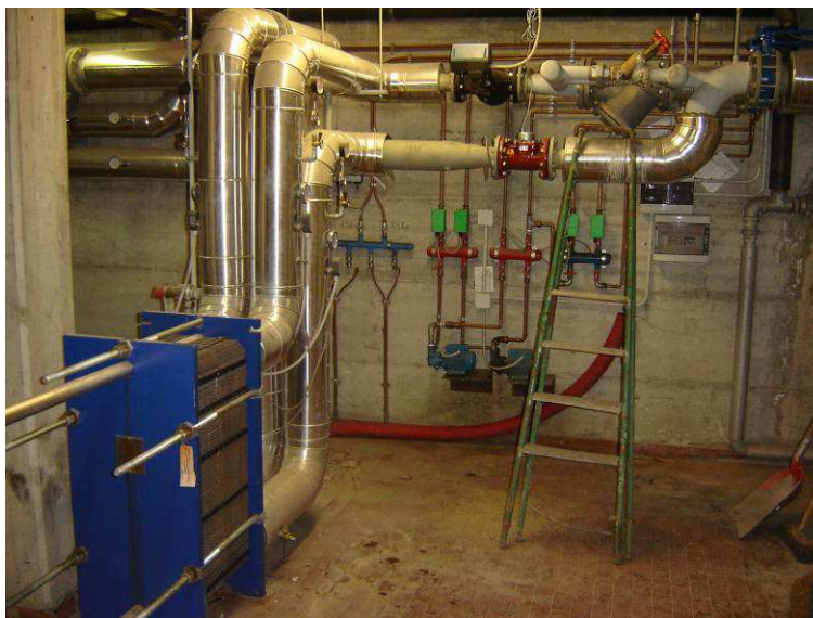
Figura 8 - Centrale termica sita al piano interrato della Scuola Elementare
