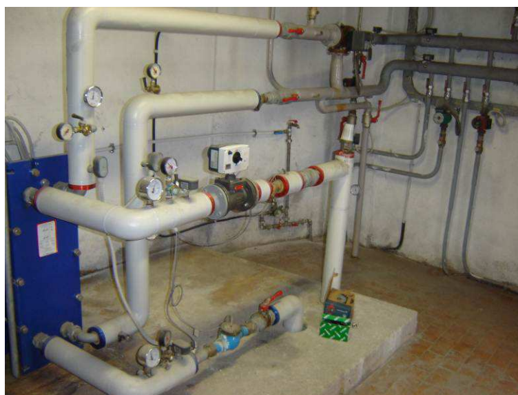
Figura 12 - Centrale termica sita al piano seminterrato del nuovo municipio
