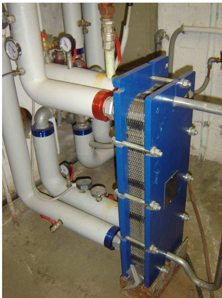
Figura 10 - Centrale termica sita al piano seminterrato dell'edificio
