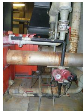
Pompes de recyclage et retour mal calorifugé
