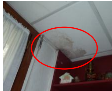
Logement - Traces d'humidité au plafond
