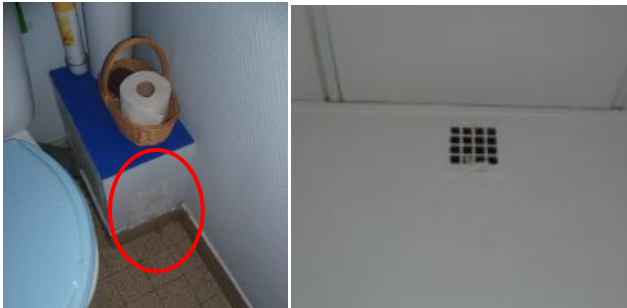
Logement - Grilles d'aération naturelle
