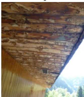
Avant-toit très vétuste avec ventilation
