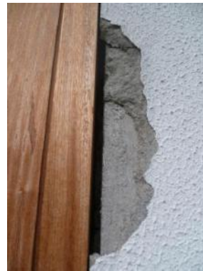
Mur Bassin - Eclat à l'encadrement d'une fenêtre
