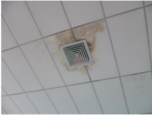
Bouche de reprise avec traces d'humidité autour
