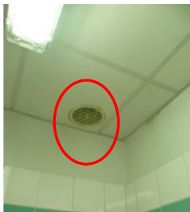
Douches - Bouche de VMC encrassée
