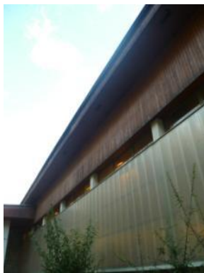
Ancien Gymnase - Paroi polycarbonate de faible performance et simple vitrage en partie haute
