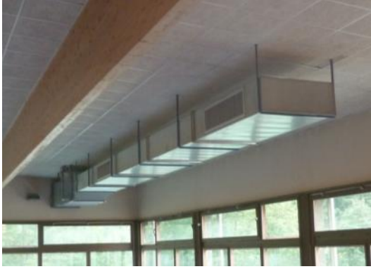
Aérotherme sur air neuf H.S.
