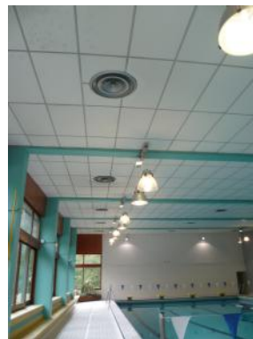
Bouches de soufflage au dessus du bassin (de part et d'autre)
