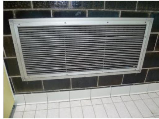
Grille de reprise verticale située en bout de bassin
