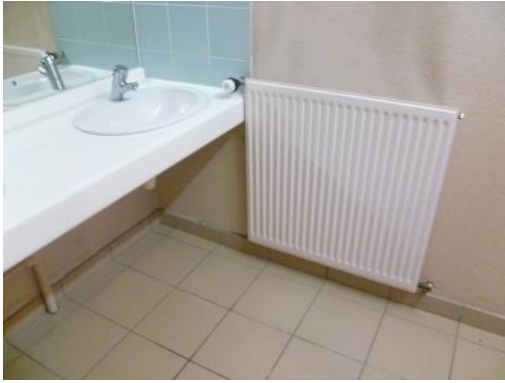
Vestiaires nouveau gymnase - Radiateur en acier
