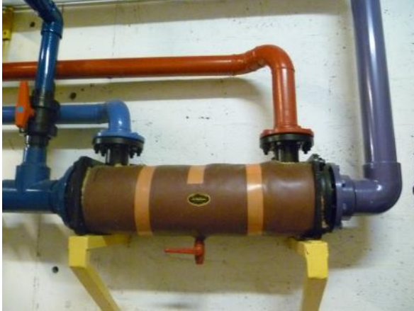
Echangeur de chauffage de l'eau du bassin
