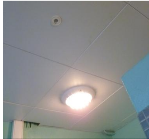
Vestiaire ancien gymnase - Fluocompacte et détecteur de mouvement
