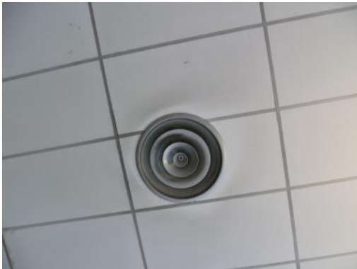
Bassin - Bouche de soufflage d'air
