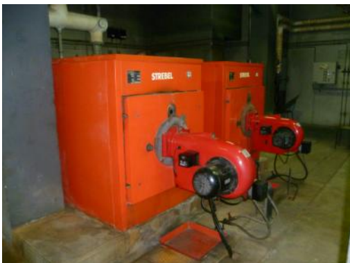
Chaudières STREBEL et brûleurs WEISHAUP T
