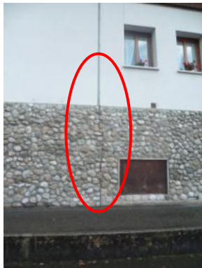
Mur Nord - Présence de fissures importantes
