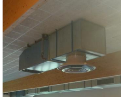
Aérotherme en reprise et brassage d'air H.S.
