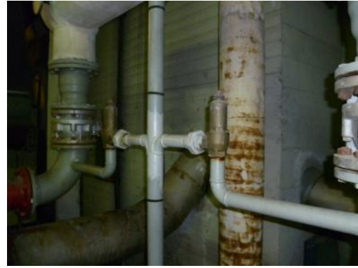
soupapes de sécurité sur le départ
