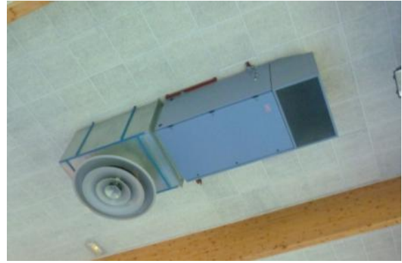
nouveau gymnase - aérotherme non utilisé
