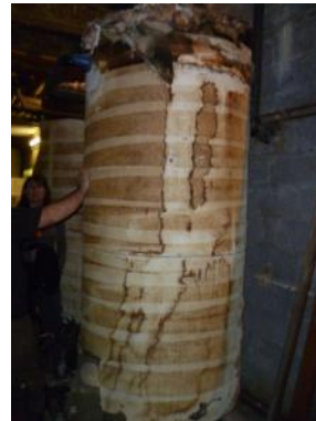
Ballons ECS de 1000 L pour les l'ancien gymnase et la piscine ; état vétuste
