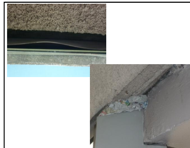
Joint d'étanchéité dégradé et calfeutrage de fortune
